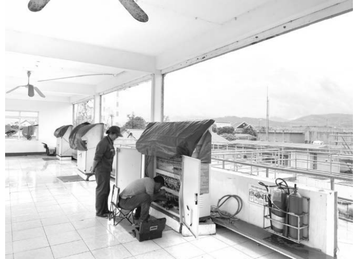
Hình 4. Nhân viên Xí nghiệp nước Ưông Bí sửa chữa tủ điều khiển bị hư hỏng do bão số 3 gây ra.
