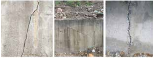
Hình 4. Các dạng nứt nghiêm trọng chắn trọng lực bê tông tại đường TTBG tỉnh Cao Bằng. Các vị trí đo được đánh số lần lượt VT1, VT2 và VT3. Công tác đo thực hiện đợt đầu tiên bắt đầu từ ngày 18/11/2024, chu kỳ đo 15 ngày/lần, kéo dài trong 90 ngày. Kết quả đường cong biến thiên vị trí vết nứt thể hiện ở Hình 5, còn đường cong biến thiên chiều dài và độ sâu thể hiện ở Hình 6.
